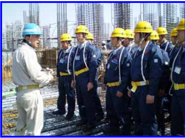
13階のコンクリート打設作業の見学(堀工事長による案内)
